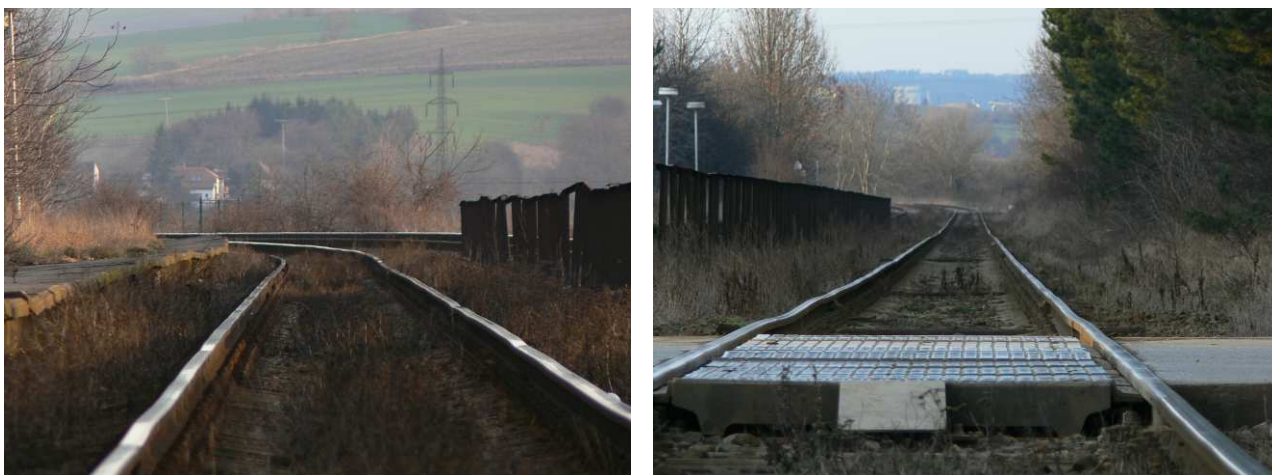
Obr.6 Pohled na stav železničního svršku na trati č. 340
